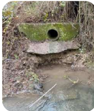
Erosion sous le rejet d'eau pluvial
